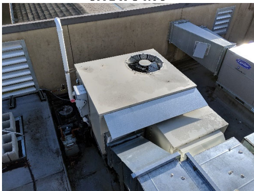
SITE A C-RTU
